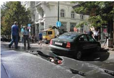
Gatekollaps pga erosjon rundt rør (Praha).
