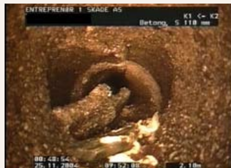
Gammel stikkledning for avløpsvann.
