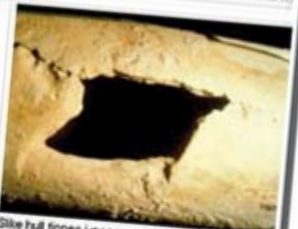
Slike hull finnes i mange av vannrørene rundt om i landet. Dette vannrøret er fra vannverket i Drammen kommune. (Foto: Christen Ræstad)
