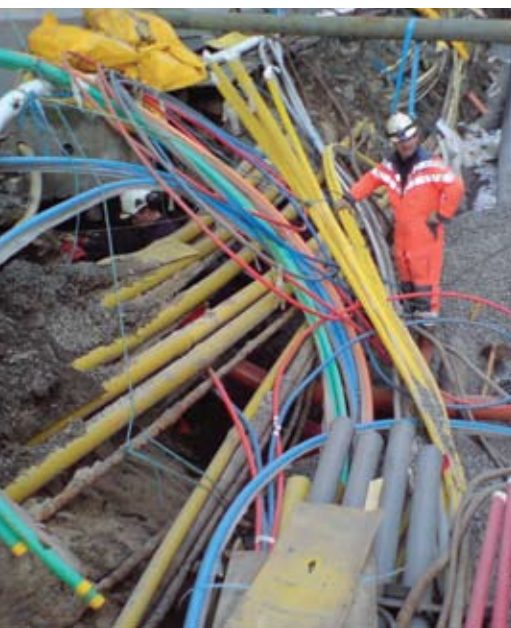
Illustrasjonsfoto: Kabelanlegg i gate i Arendal
